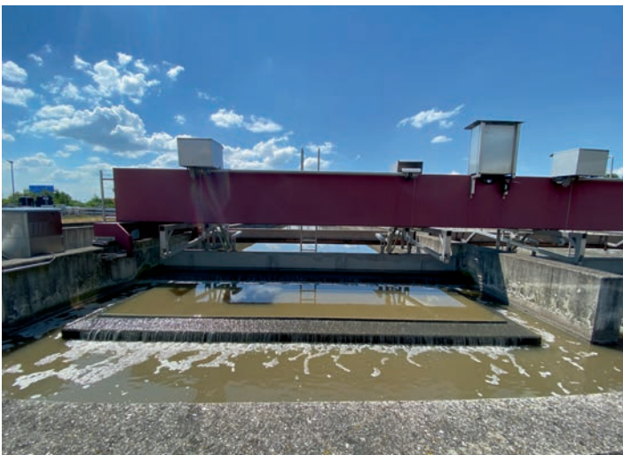
Bild 2: Längsbecken, von denen zwei ständig im Betrieb (Sommer- und Winterbecken) sind (Bild: WAD GmbH)
