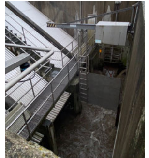
Bild 2: Jede unserer Schnecken schafft es, 560 l/s anzuheben. Der Zulauf bei Trockenwetter beträgt durchschnittlich 17.000 Kubikmeter Abwasser/Tag. Bei Regenwetter verzeichnen wir einen Zulauf von bis zu 1200l/s. Dafür ist unsere Kläranlage auch bei Havariefällen ausgelegt, um eine stabile Abwasserbehandlung zu gewährleisten (Bild: WAD GmbH)
